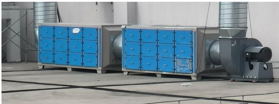
废气处理设施
