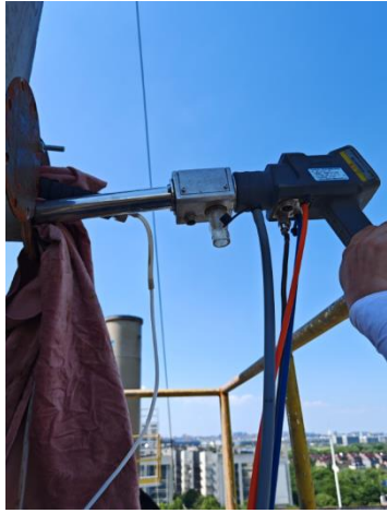
定型废气排放口（DA004）
