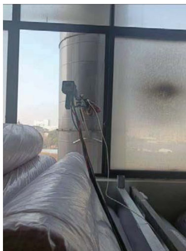
废气净化设施
