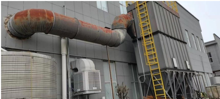
粉尘废气处理设施
