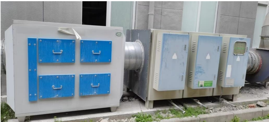
挤出废气、覆膜废气处理设施
