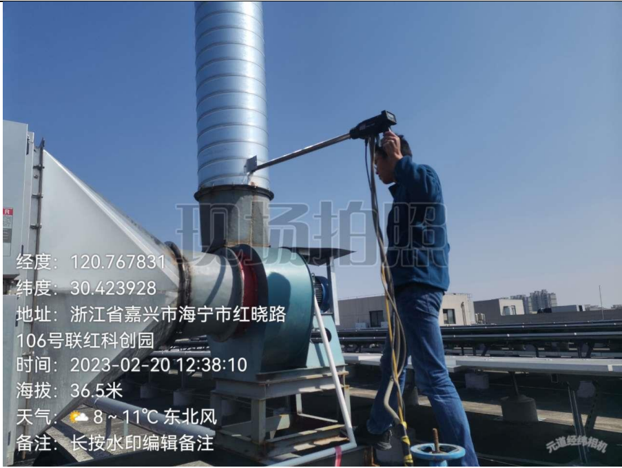
有机废气处理设施
