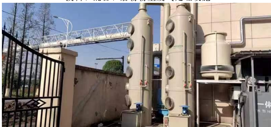
次氯酸钠+碱喷淋装置
