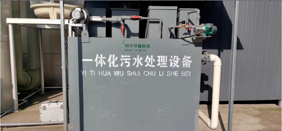
废水处理装置
