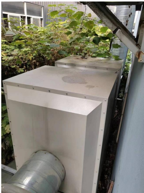
挤出废气处理设施
