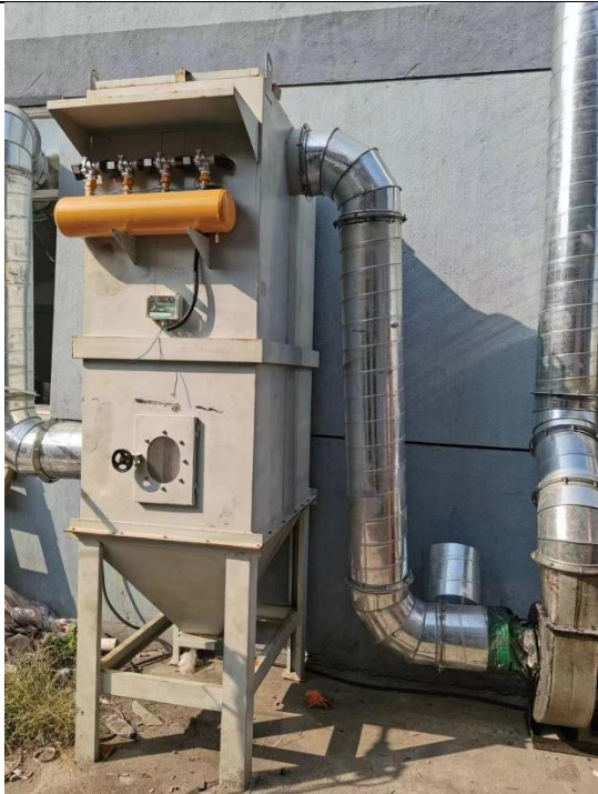
投料、上料粉尘废气处理设施
