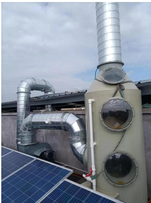
复合工艺废气处理设施
