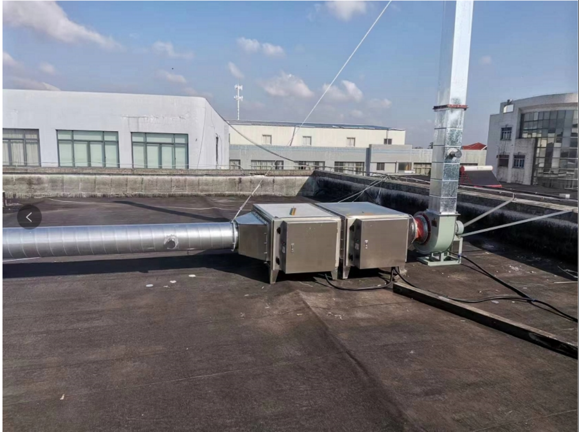
有机废气处理设施
