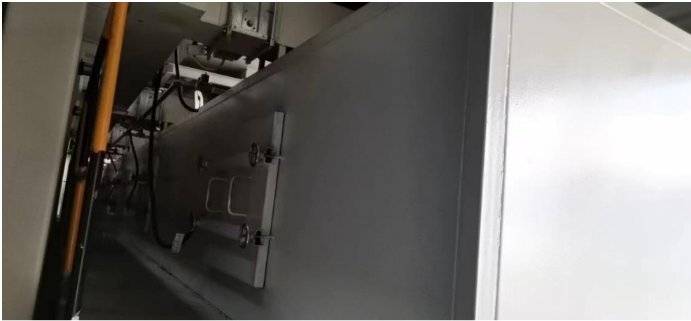
有组织废气处理设施
