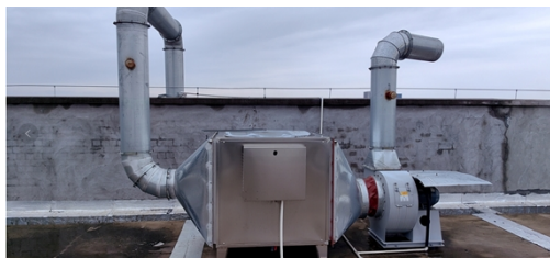
退火废气处理设施
