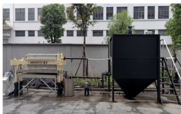
废水处理设施
