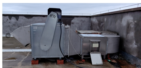
油烟废气处理设施
