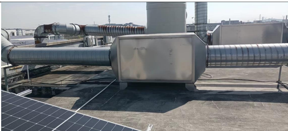
挤出工艺废气处理设施
