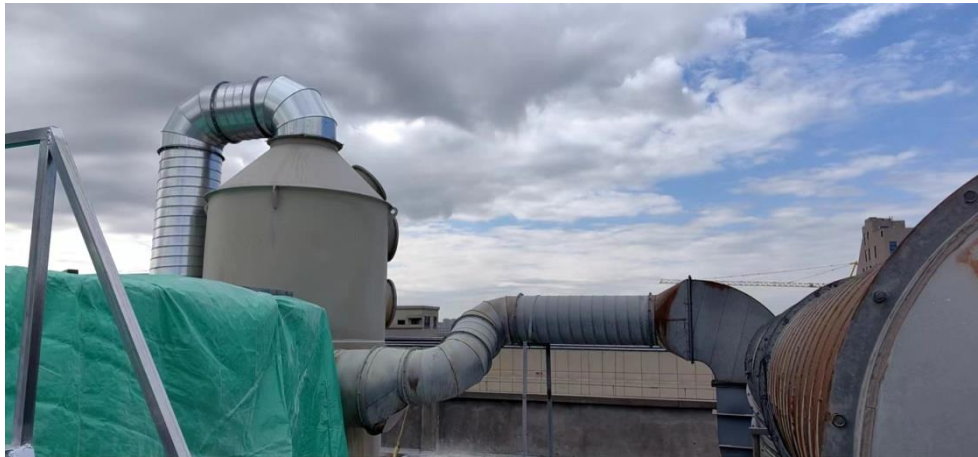
固化废气、燃烧废气废气处理设施
