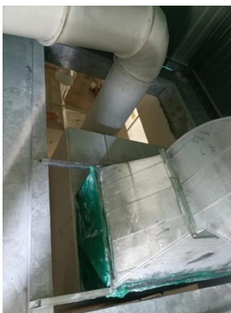
注塑工艺废气处理设施
