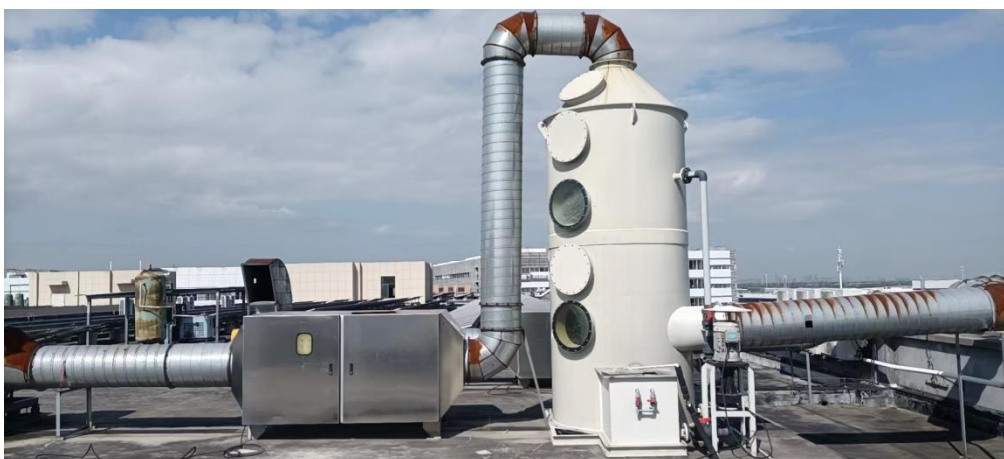
印刷工艺废气处理设施
