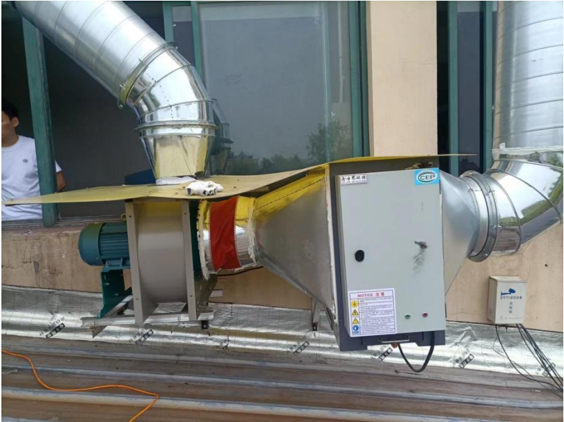
注塑工艺废气处理设施
