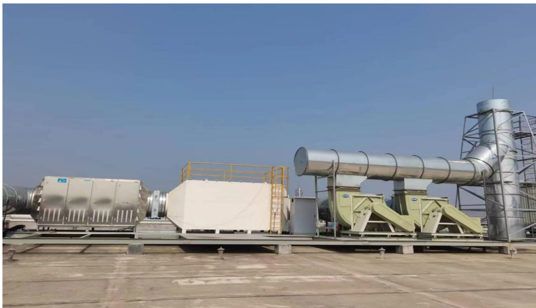
有机废气处理设施
