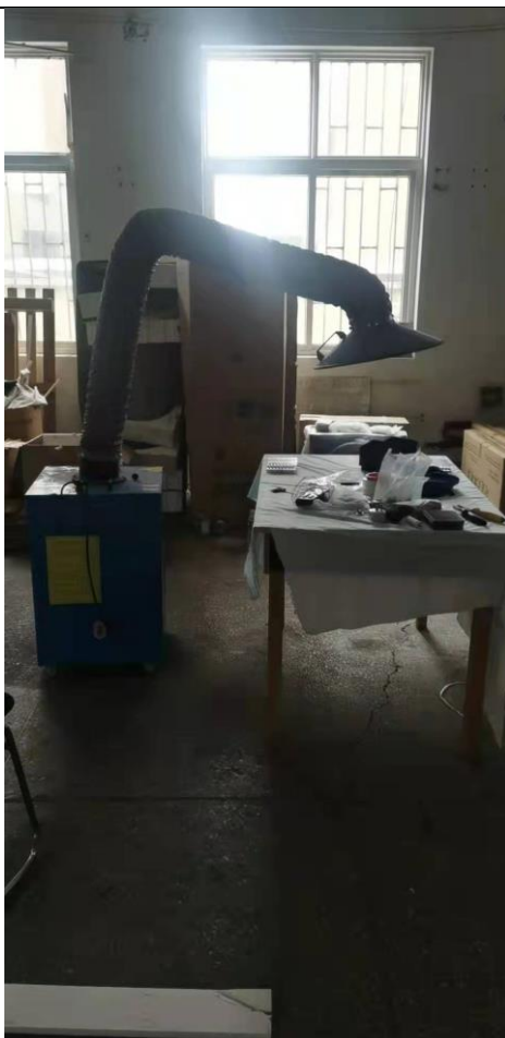
焊接废气处理设施
