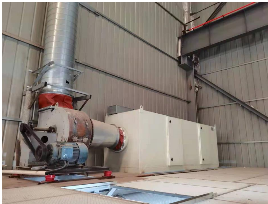
注塑废气处理设施
