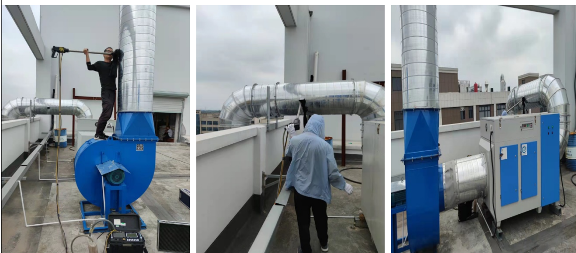
吹塑有组织废气进出口及净化设备
