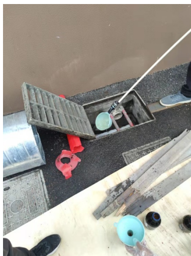
生活污水排放口
