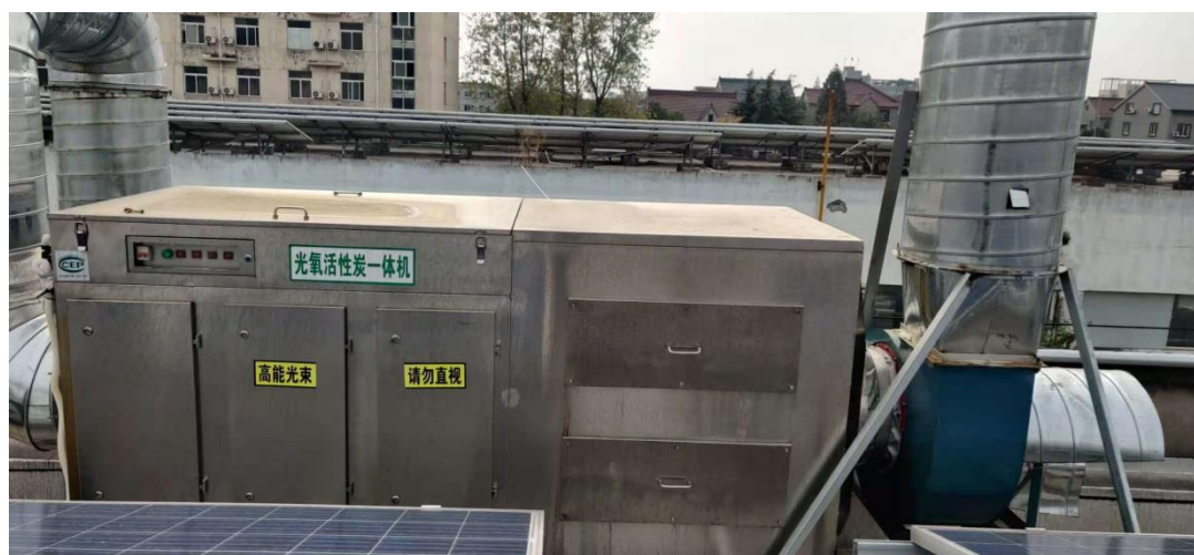
固化工艺废气处理设施
