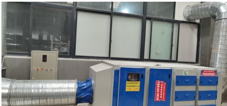
焊接、注塑废气处理设施
