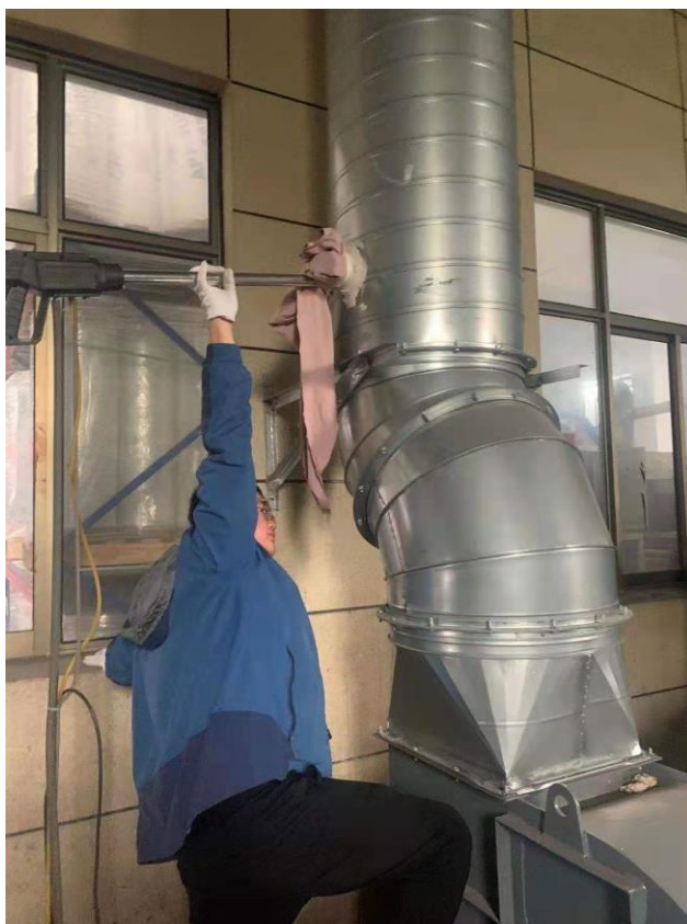
废气处理设施
