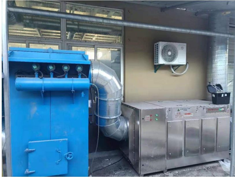
焊接、注塑废气处理设施
