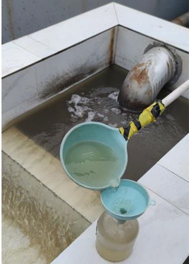
废水处理设施出口（废水总排口）
