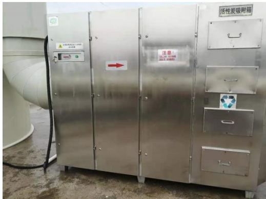
污水站除臭塔
