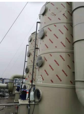
污水站除臭塔
