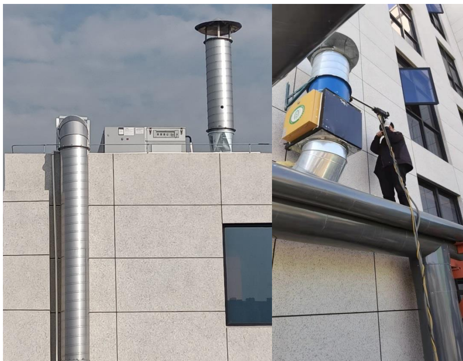
预发泡废气处理设施和食堂油烟废气处理设施
