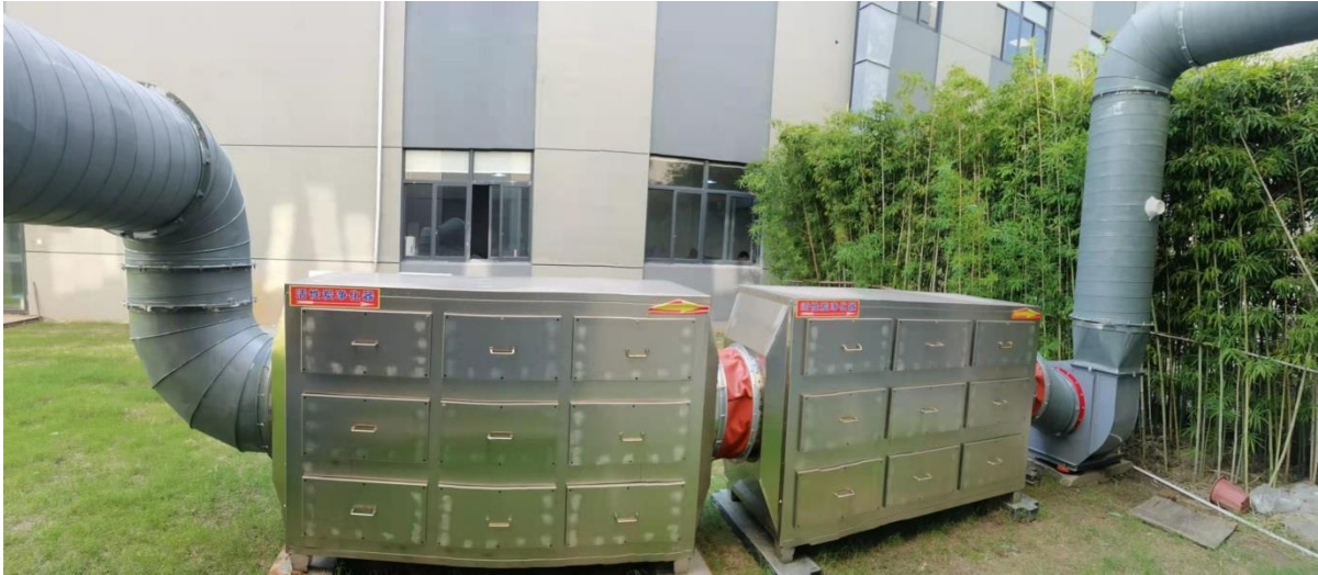
挤出废气处理设施
