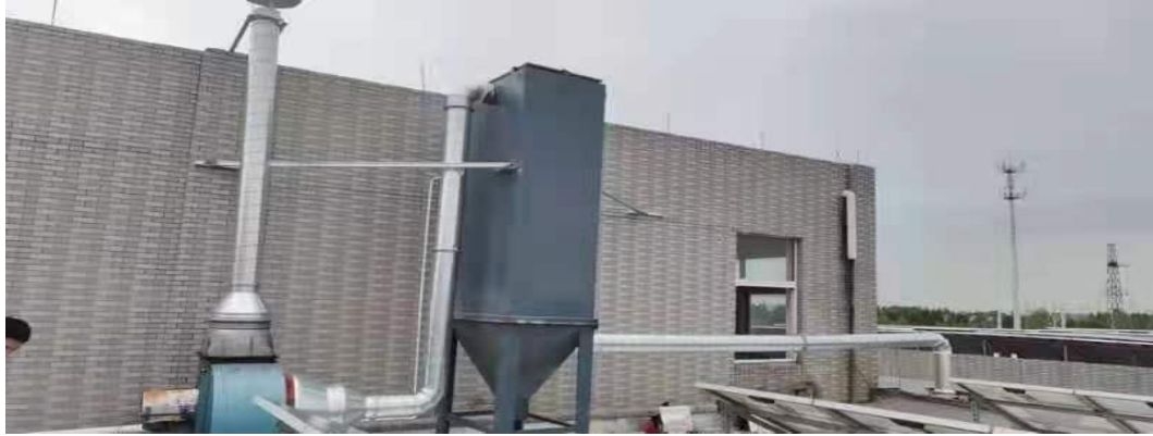
破碎粉尘、粉碎粉尘废气处理设施
