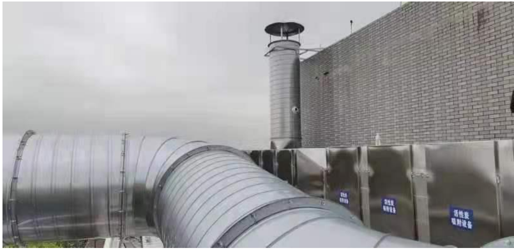
挤出压延、吸塑、制杯和成型废气、洗车废气、印刷废气废气处理设施
