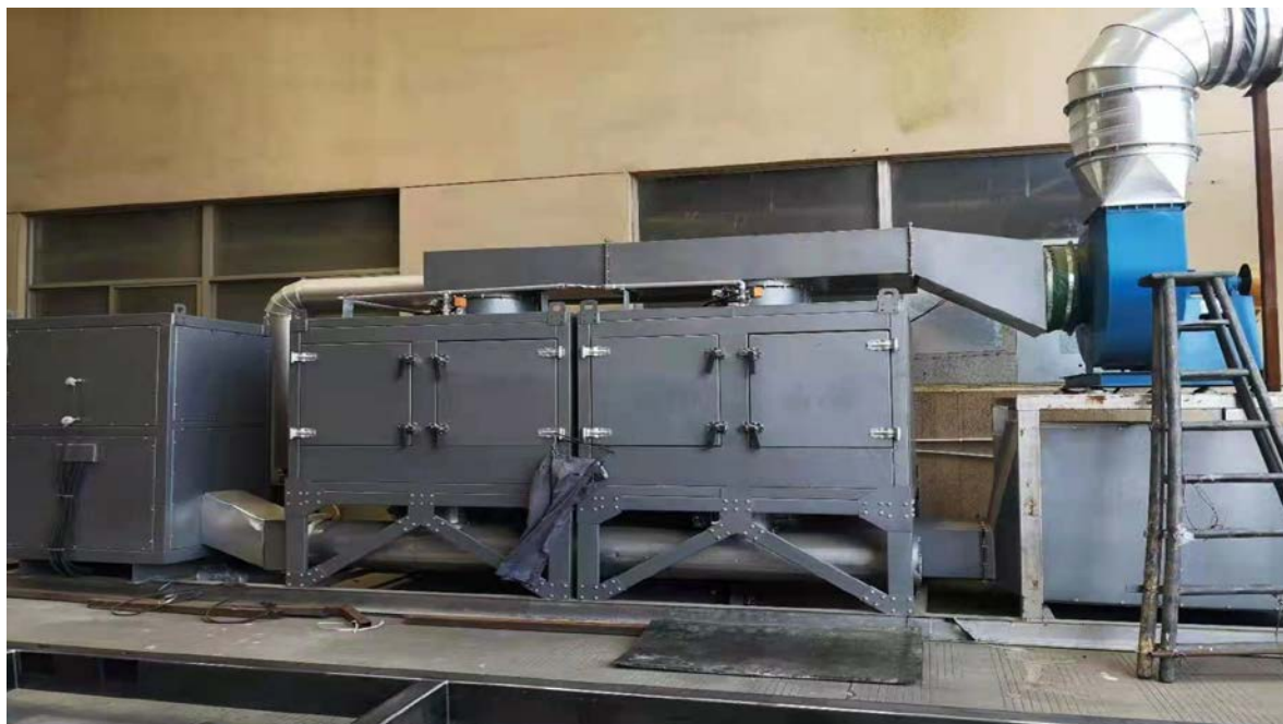
喷漆废气处理设施
