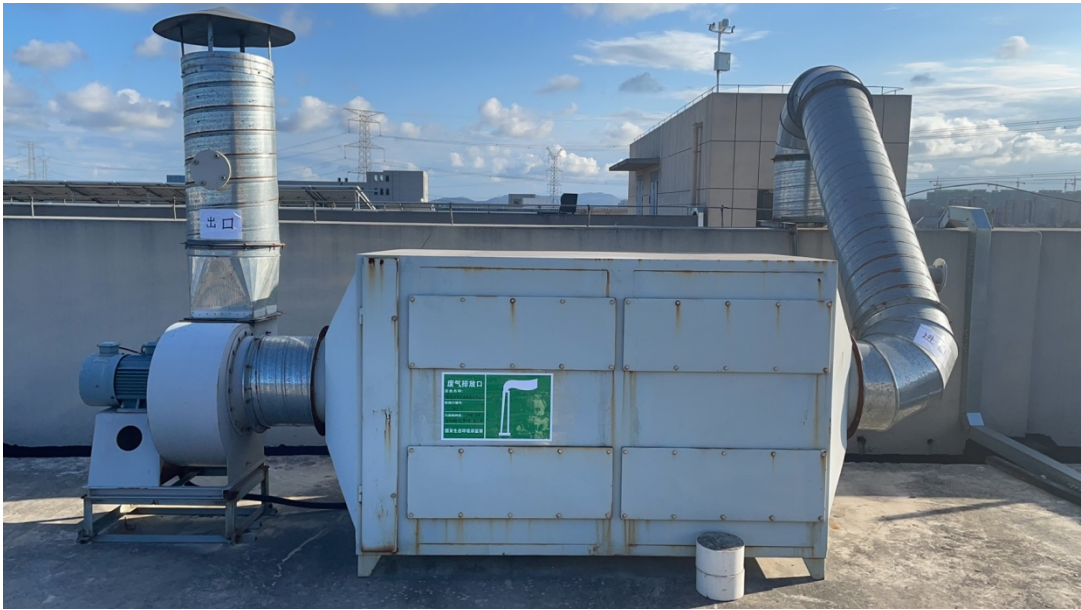
焊接、注塑废气处理设施
