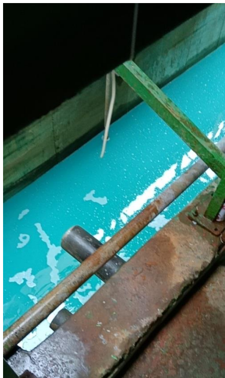
废水收集池（生产废水进口）
