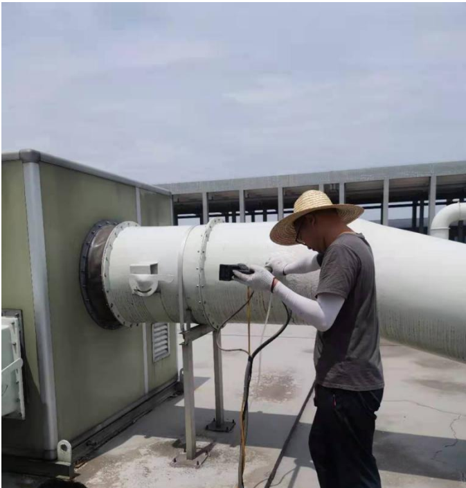
废气处理设施
