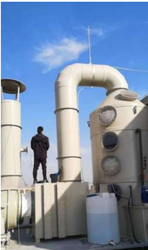
废气处理设施
