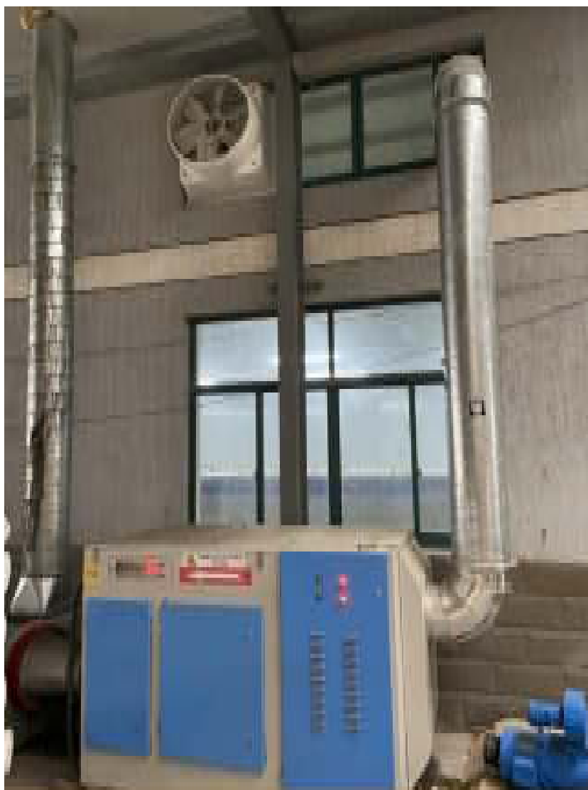
图 4-2 废气治理设施照片
