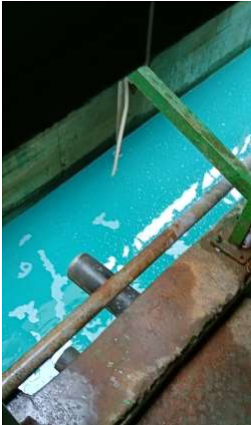
生产废水进口
