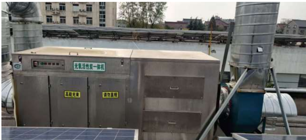
固化工艺处理设备
