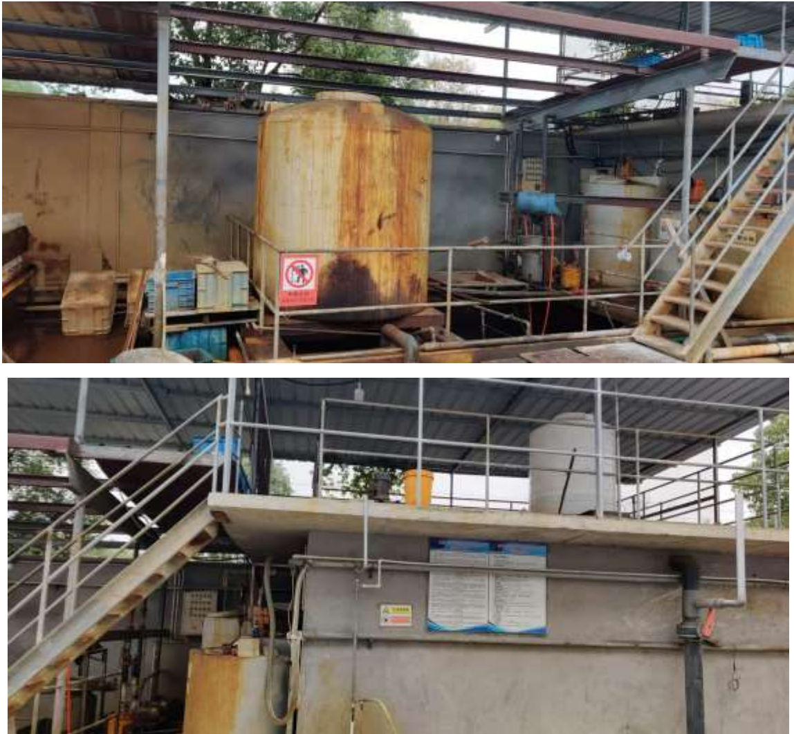
废水处理设施
