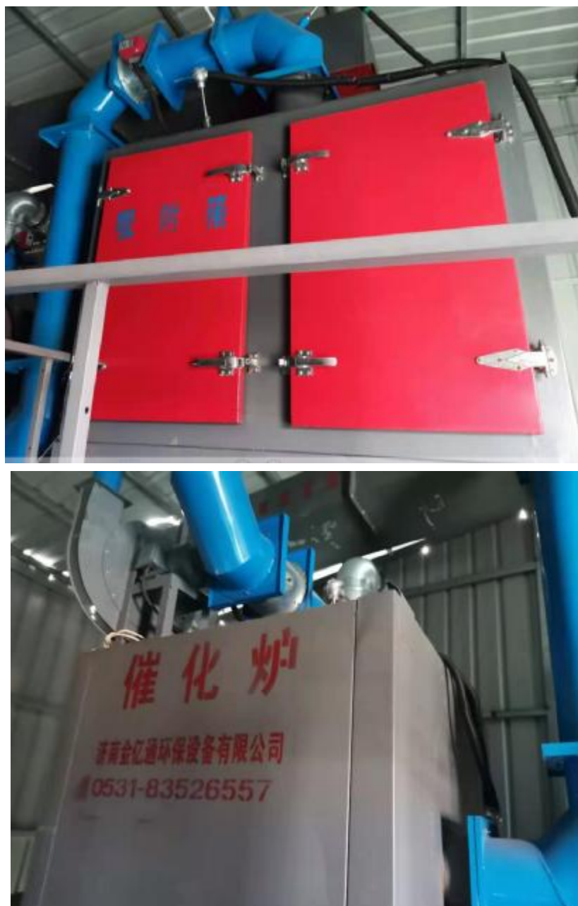
图 4-3 催化燃烧装置现场照片图
