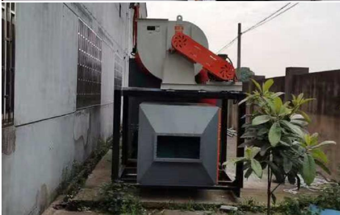
图 4-3 催化燃烧装置现场照片图
