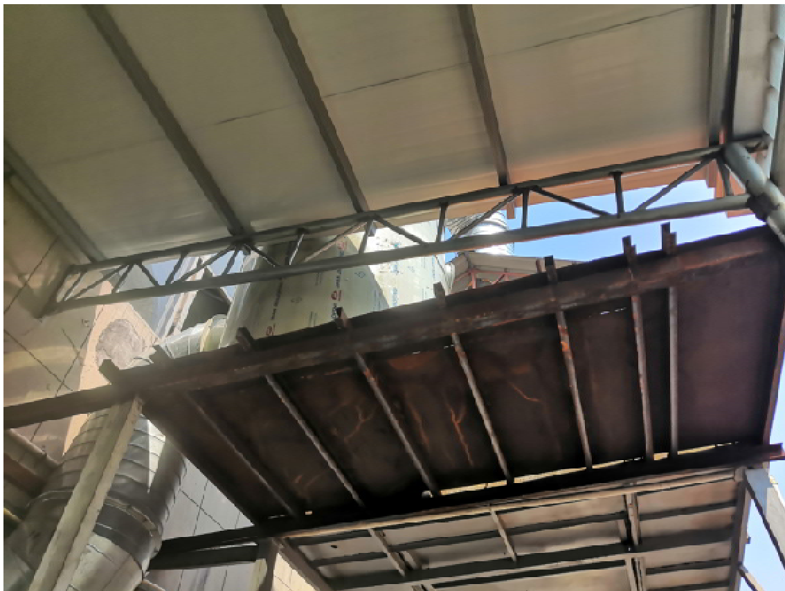
图 4-3 废气治理设施照片（2）
