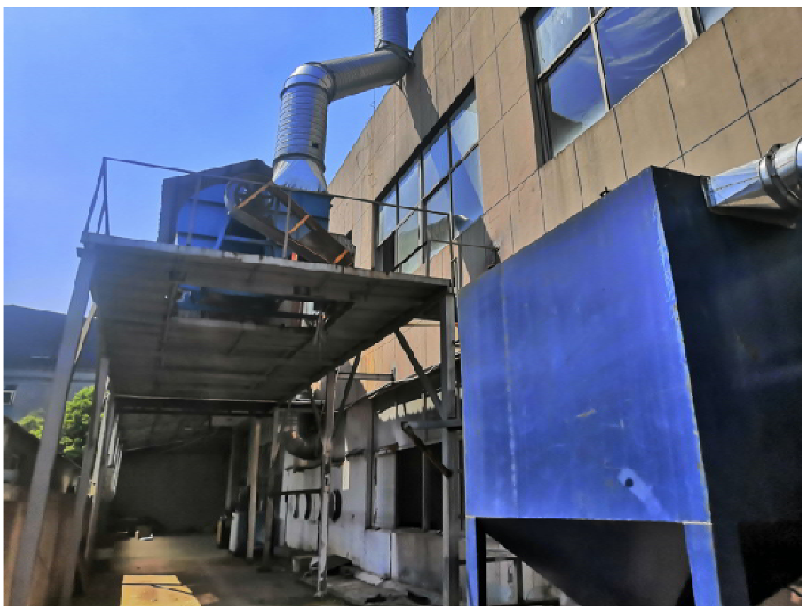
图 4-2 废气治理设施照片（1）
