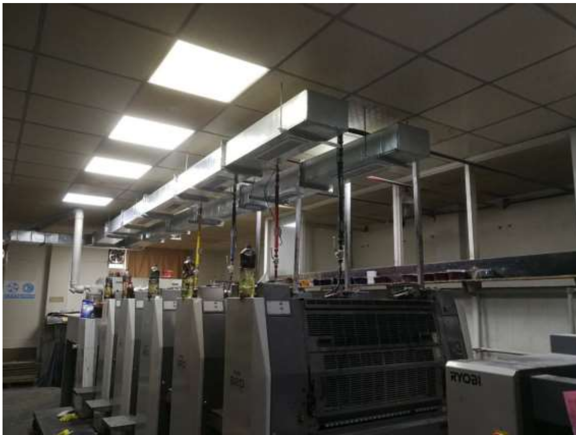
图 4-2 废气收集系统照片
