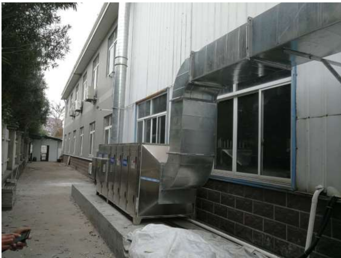
图 4-3 废气处理设施照片
