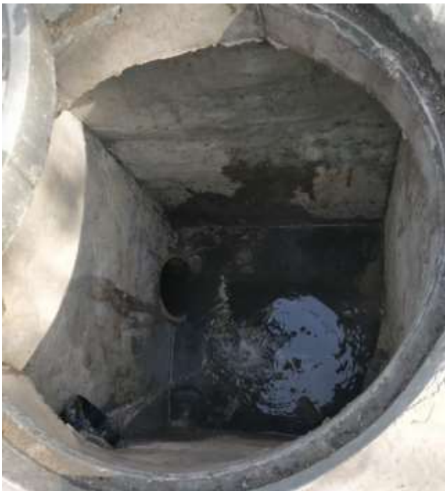
生活污水排放口
