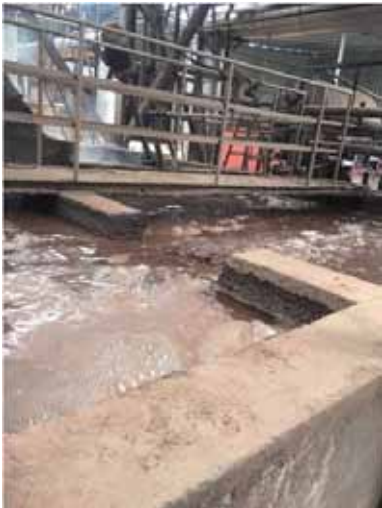
废水处理设施进口
