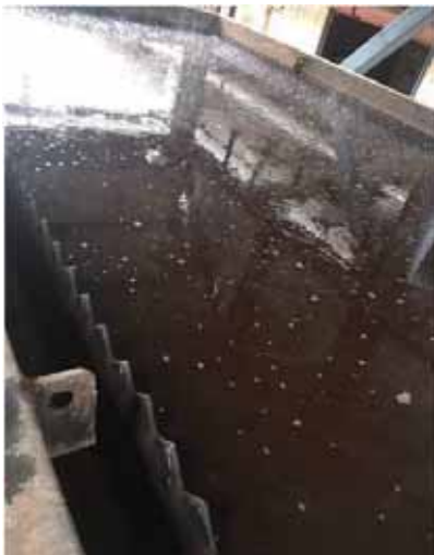
废水处理设施出口
