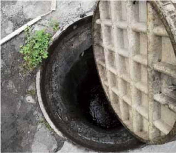
生活污水出口
