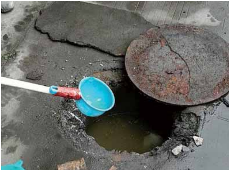
生活污水入网口
