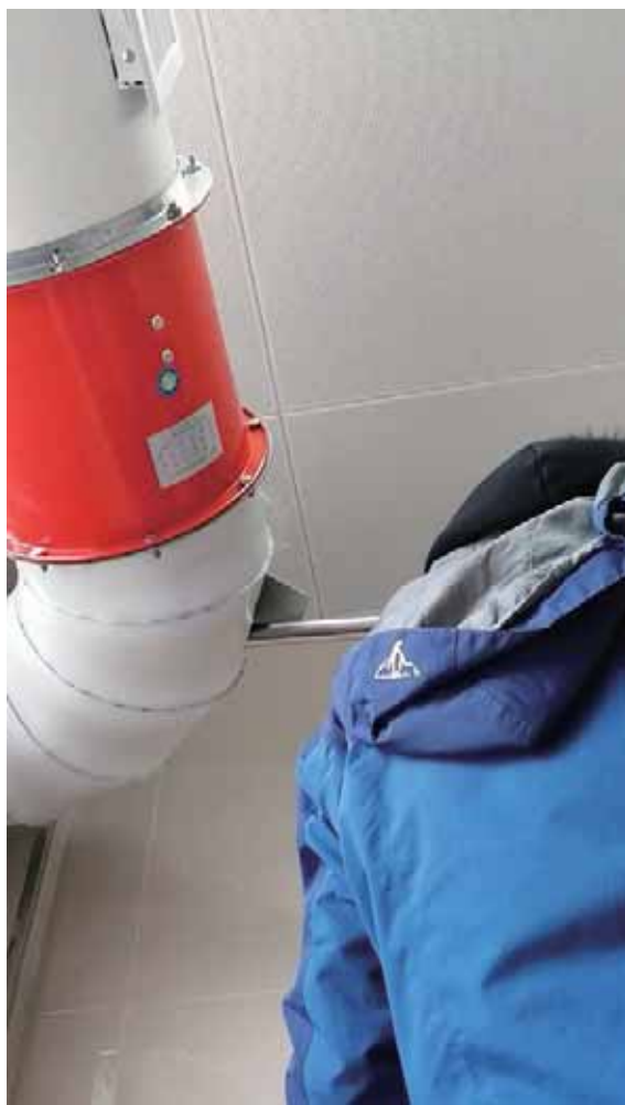
污水站废气采样口
