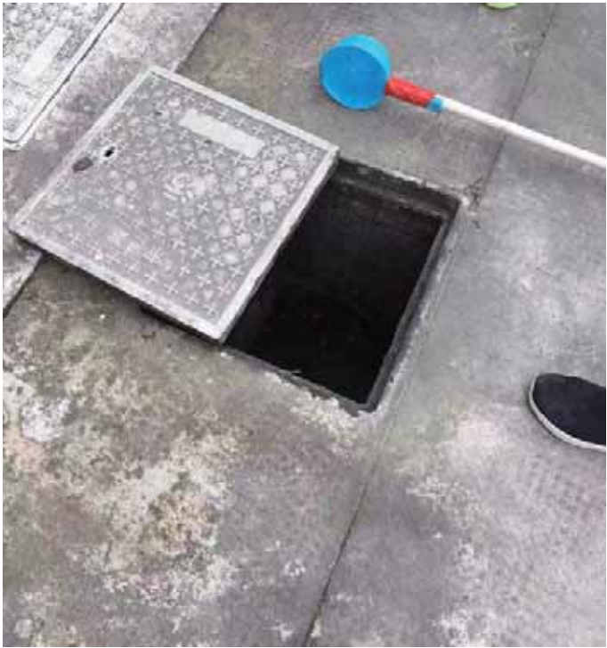
生活污水入网口
